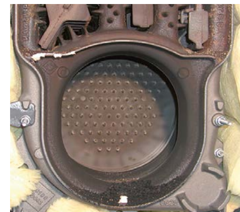
Chambre de combustion d'une chaudière après 1800 heures de fonctionnement au mazout Eco pauvre en soufre.
