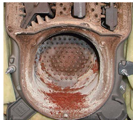
Chambre de combustion d'une chaudière après 1800 heures de fonctionnement (durée de fonctionnement moyen d'un chauffage en Suisse par an) dues à la combustion de mazout de qualité Euro.
