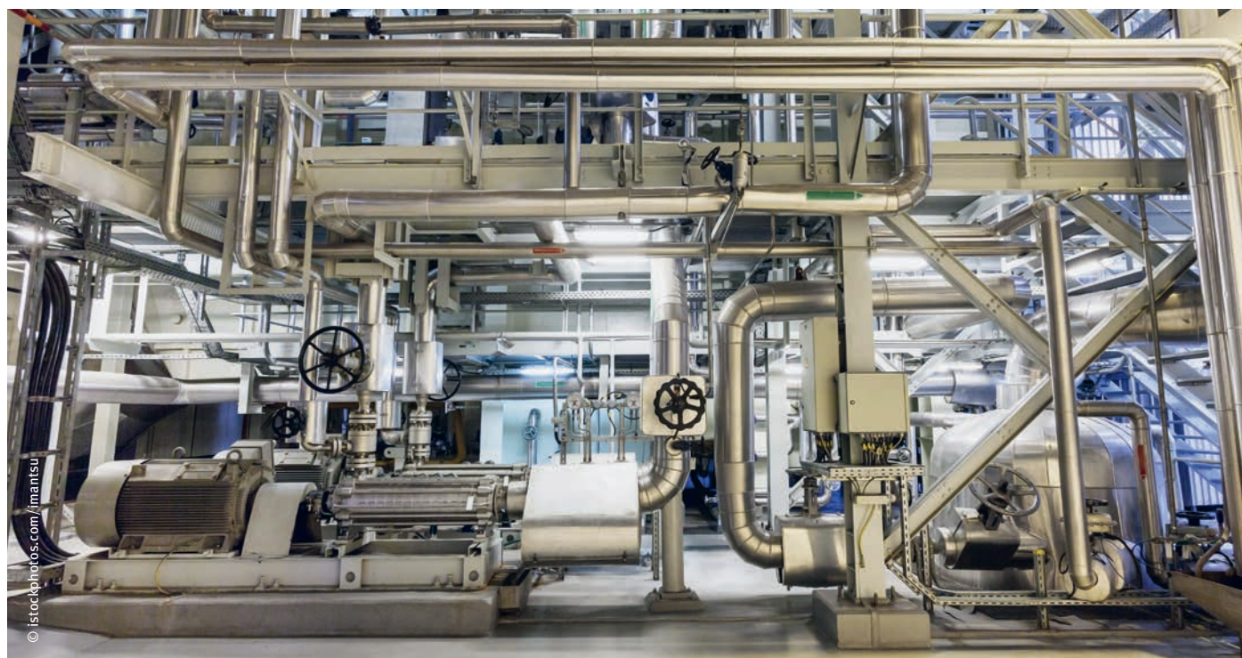
Centrale de cogénération moderne de moyenne puissance
