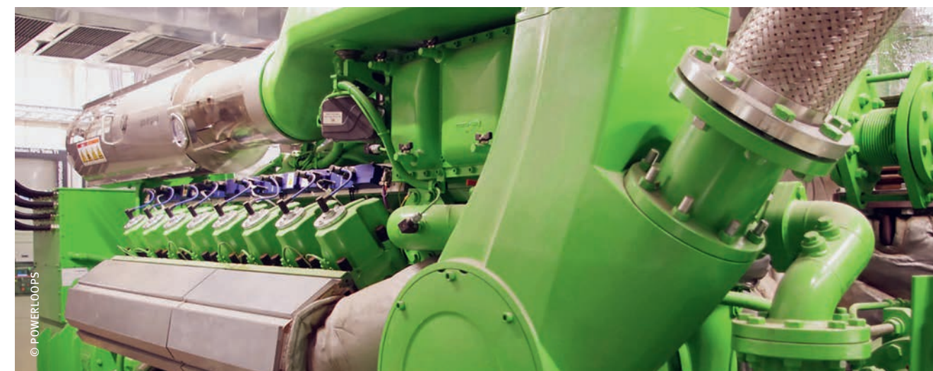
Moteur à gaz 16 cylindres de la centrale thermique de Charmey
