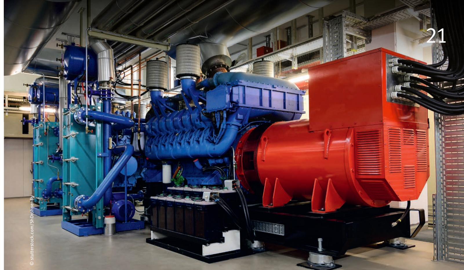
Grand groupe électrogène diesel de secours pour un centre de calcul.
