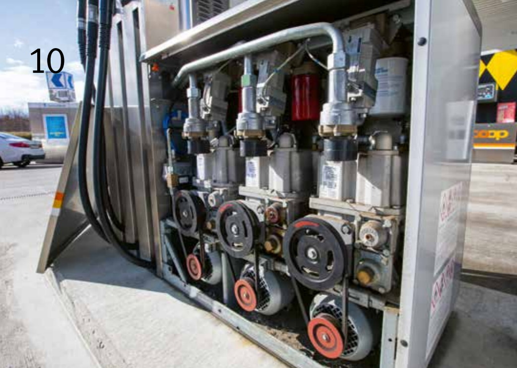
Les compteurs se trouvent directement au-dessus des pompes et sur les conduites de carburant. C'est là qu'est mesuré le débit afin de déterminer la quantité que est en train de pomper.
